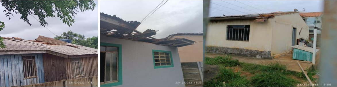
Figura 101 - Danos registrados em 23/12/2023, Ponta Grossa/PR
