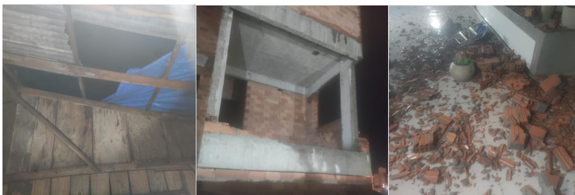
Figura 60 - Danos registrados em 12 de julho de 2023, Ponta Grossa/PR (1)
