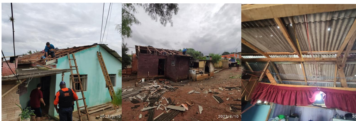
Figura 51 - Danos registrados em 09 de março de 2023, Ponta Grossa/PR (2)
