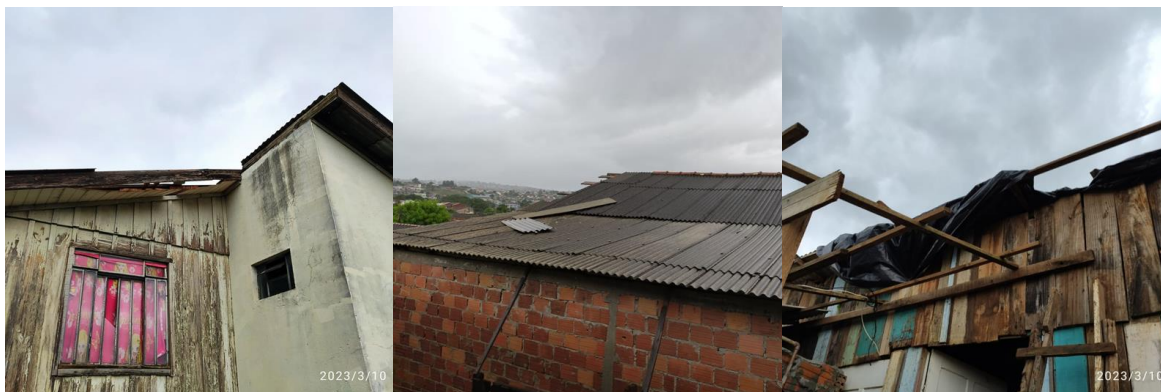
Figura 50 - Danos registrados em 09 de março de 2023, Ponta Grossa/PR (1)
