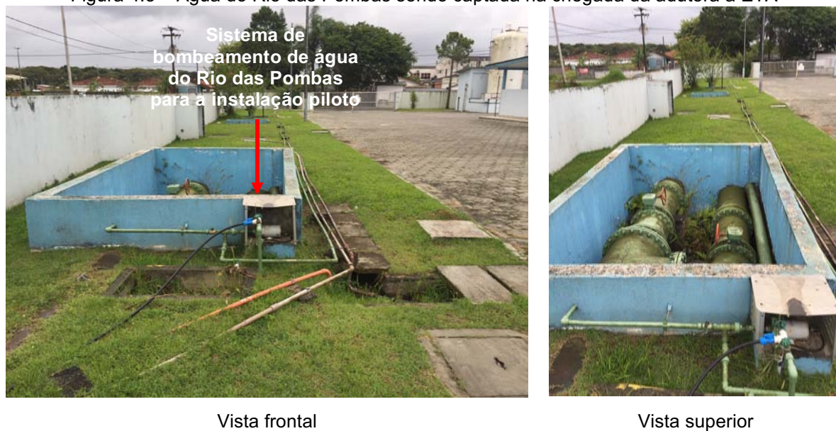
Figura 4.3 – Água do Rio das Pombas sendo captada na chegada da adutora a ETA
