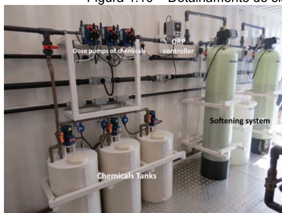
Dosagem de antiscaling, antifouling e metabissulfito
