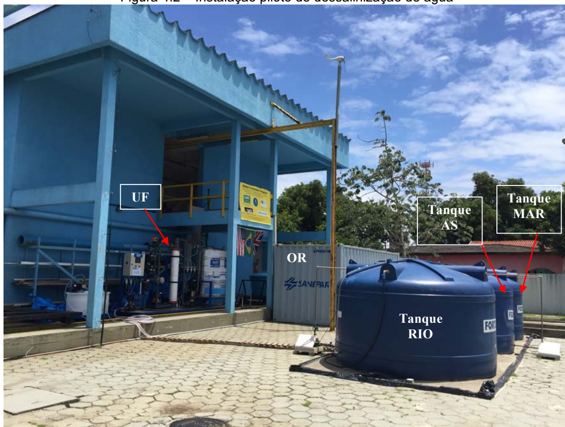
Figura 4.2 – Instalação piloto de dessalinização de água
