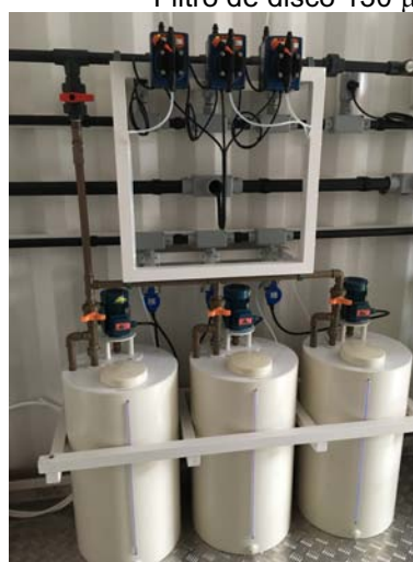
Bombas dosadoras e reservatórios de produtos químicos
