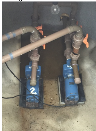
Sistema de bombeamento
