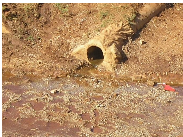
FIGURA 54 - ESGOTO LANÇADO NA RUA EM SÃO JOSÉ
