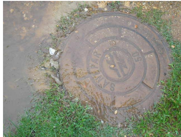
FIGURA 51 - POÇO DE VISITA EM SÃO JOSÉ EXTRAVAZANDO
