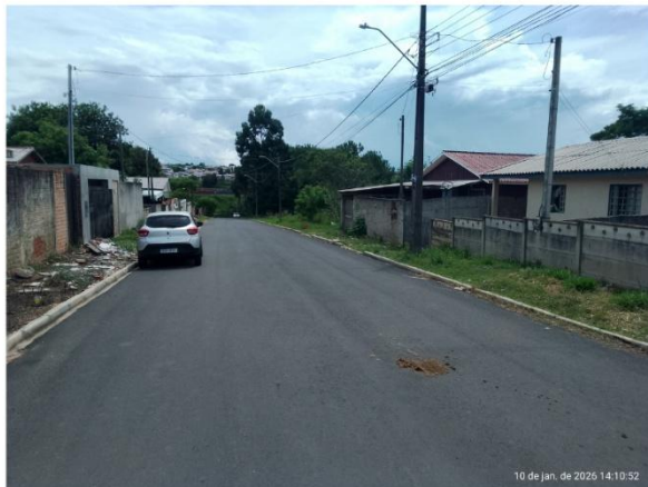
T - Pavimento na R. Walter Glass
