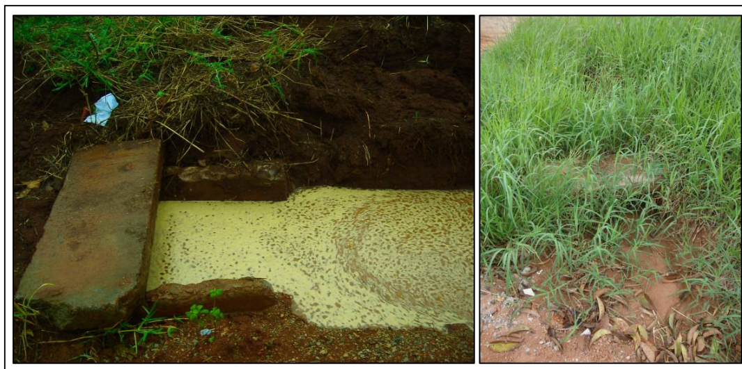
FIGURA 17 – Manilha para captação de água pluvial entupida localizada à esquerda da Rua Rio Amazonas no cruzamento com a Rua Rio Nilo. Foto da esquerda obtida em setembro de 2009 e da direita em janeiro de 2010.
