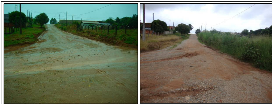
FIGURA 14 – Vista da Rua Rio Nilo no cruzamento com a Rua Rio Amazona em setembro de 2009 e janeiro de 2010 respectivamente. É possível observar que houve formação de sulcos de erosão.
