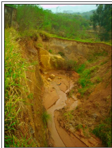
FIGURA 24 – Vista da porção mais a jusante do canal C5. Este encontra-se bastante erodido e há pouca vegetação em seu interior. Fotografias obtidas em 03 de setembro de 2009.
