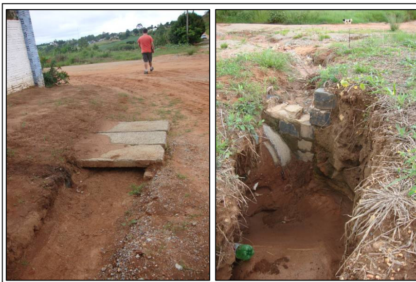
FIGURA 18 – Manilhas situadas na Rua Rio Amazonas, no cruzamento com a Rua Rio Nilo. Fotografia da esquerda, manilha entupida localizada no lado direito. Fotografia da direita ilustra a outra extremidade da manilha, dentro do canal C2, entupida por de sedimentos. (jan. 2010)
