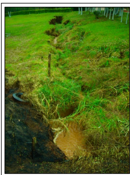
FIGURA 25 – Canal C5, fotografia retratando o direcionamento da água após passar pela manilha sob a Rua Rio Nilo. Observa-se que há água acumulada próximo da lateral da rua. A água segue em direção à voçoroca. No alto da fotografia observa-se outra manilha, colocada pelo proprietário com a construção de uma via interna. (03/09/2009)
