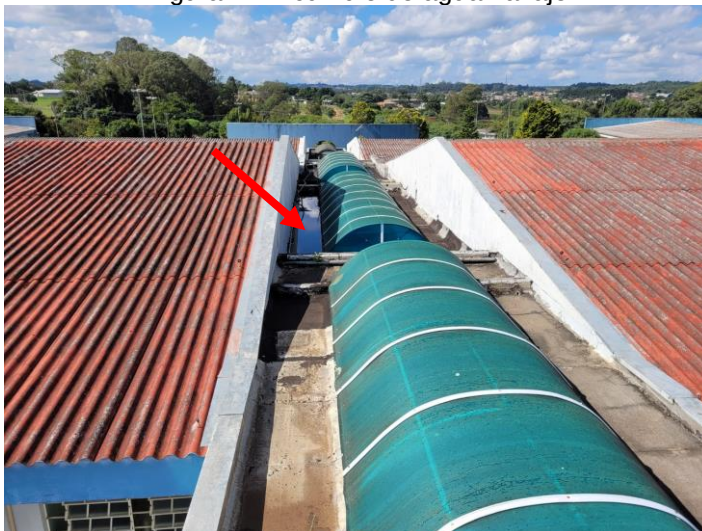
Figura 24: Acúmulo de água na laje
