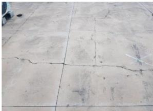
Figura 10: Fissuras de dilatação térmica
