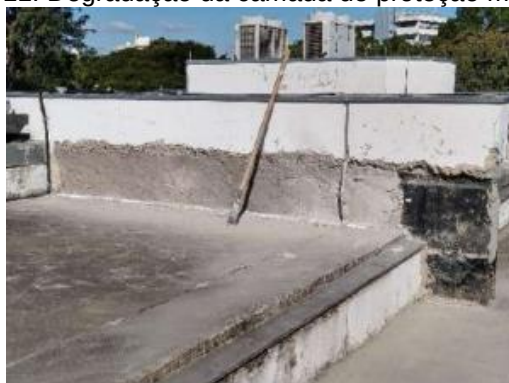
Figura 11: Degradação da camada de proteção mecânica
