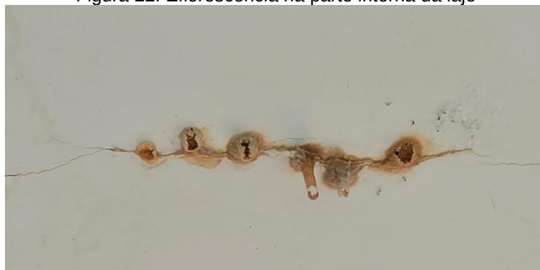
Figura 22: Eflorescência na parte interna da laje
