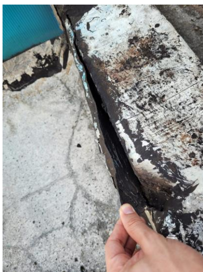
Figura 21: Detalhe do descolamento da manta
