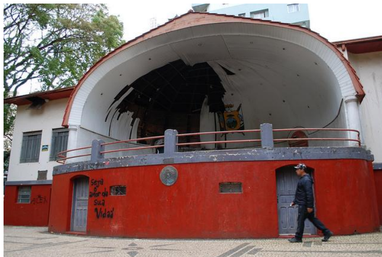
FOTO 31 – Marcas de incêndio na Concha Acústica Carlos Gomes em 2013
