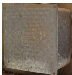
Figura 5 - Caixa de passagem elétrica utilizada como objeto de referência.
