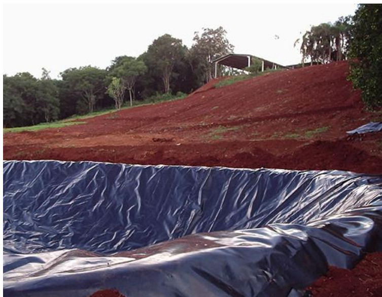
IMAGEM 13: Aterro Sanitário Pema. Sistema de Tratamento e Recirculação de Chorume. Fonte: Pema Limpeza e Conservação (2017).
