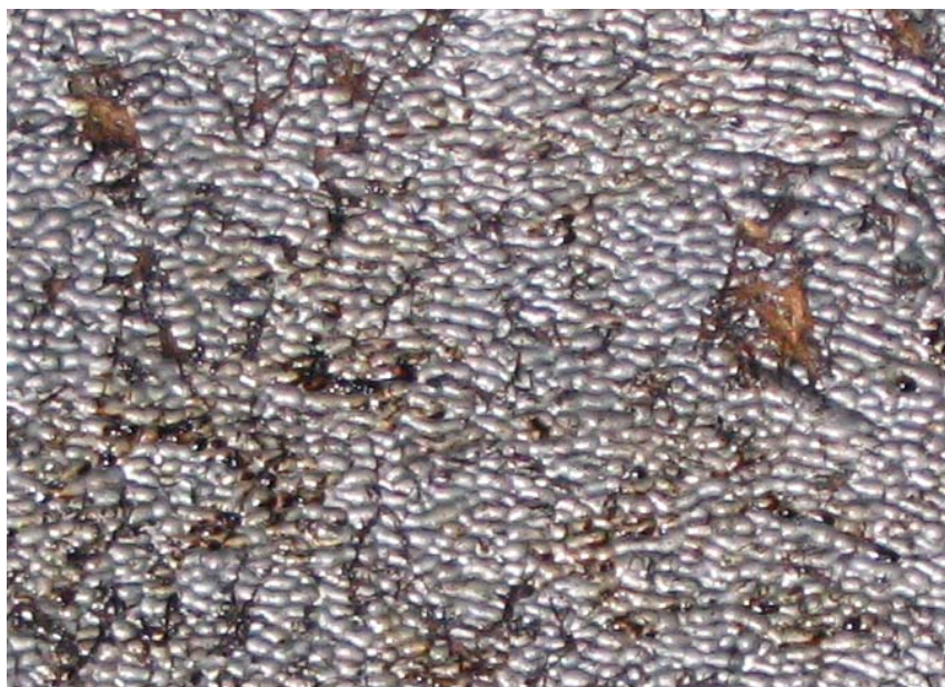
Figura 4.62 Superfície interna superior do digestor VI, aço ASTM A 516 Grau 60. (ver Anexo B).
